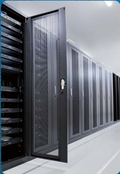
サーバーラック
