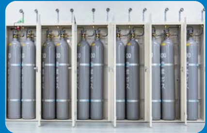
窒素ガス消火設備
